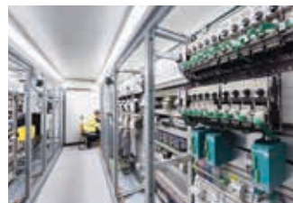
Um das Modernisierungsprojekt im Splittwerk möglichst schnell und reibungslos zu realisieren, wurden Leitstand und Elektrotechnik in einem Container angeliefert.
